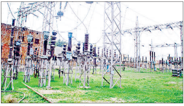
ट्रांसफार्मर जल गए थे। जिनमें नरवाना डिविजन में 202 ट्रांसफार्मर जले थे। इसके बाद
